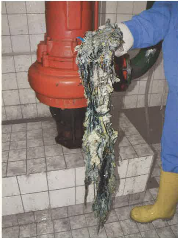
Sieht übel aus und ist es auch: verfilzte Feuchttücher. Regelmäßig legen sie Abwassersysteme lahm.
